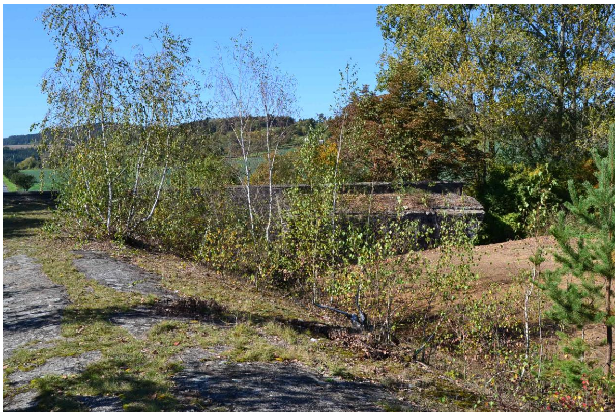
Obr. 40 Pionýrské dřeviny (bříza), zarůstající starou mostní konstrukci „Hitlerovy dálnice“ (J. Polách, 8. 10. 2012)
